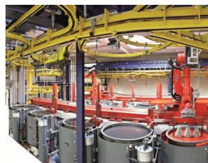
Vollautomatische Fertigungsanlage / chaîne de production entièrement automatique
